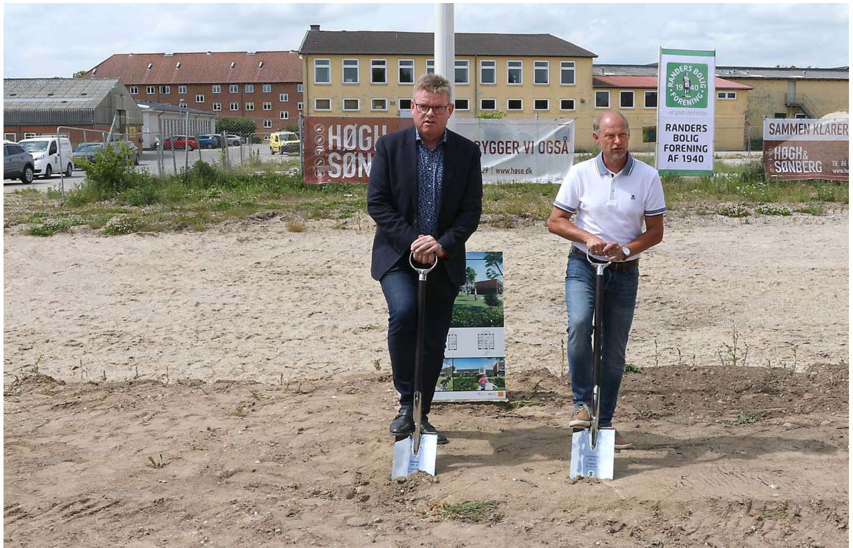
Flot så det ud, da borgmester Torben Hansen og boligforeningsformand Jan Guldmann synkront satte hver sin spade i jorden og igangsatte byggeriet. Foto: Boligforeningen af 1940
